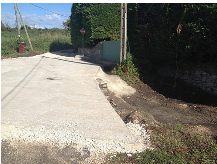
Quartier Malaric : carrefour du chemin du mas Californie, écoulement direct de l'eau vers l'Alzon
