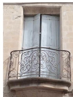
Les volets, en bois peint, repliés dans le tableau, constituent l'une des alternatives possibles lorsque la menuiserie est conçue à cet effet. 14, place Dampmartin.
