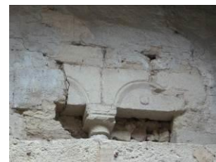
Rue de l'Épée. Fenêtre géminée romane à restituer et à rouvrir.
