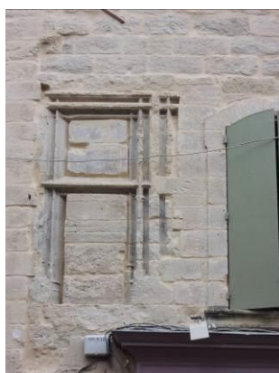
Maintien des traces archéologiques apparentes (couple fenêtre à meneau – fenêtre à traverse, seconde moitié 15 e – début 16 e siècle). Place Dampmartin.
